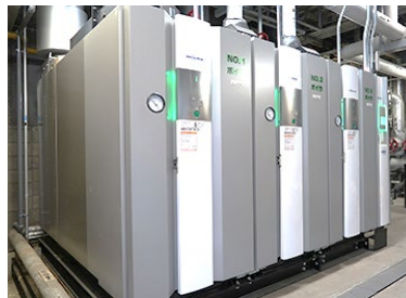
高効率ボイラー導入
